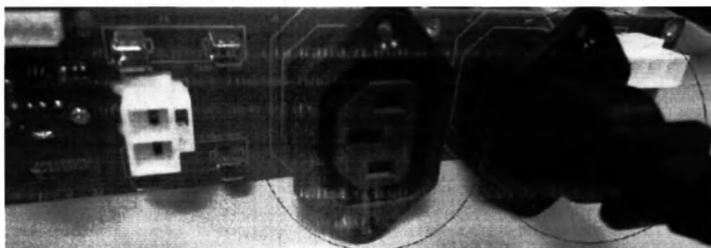
Рисунок 8.1. Проверка силовой розетки
