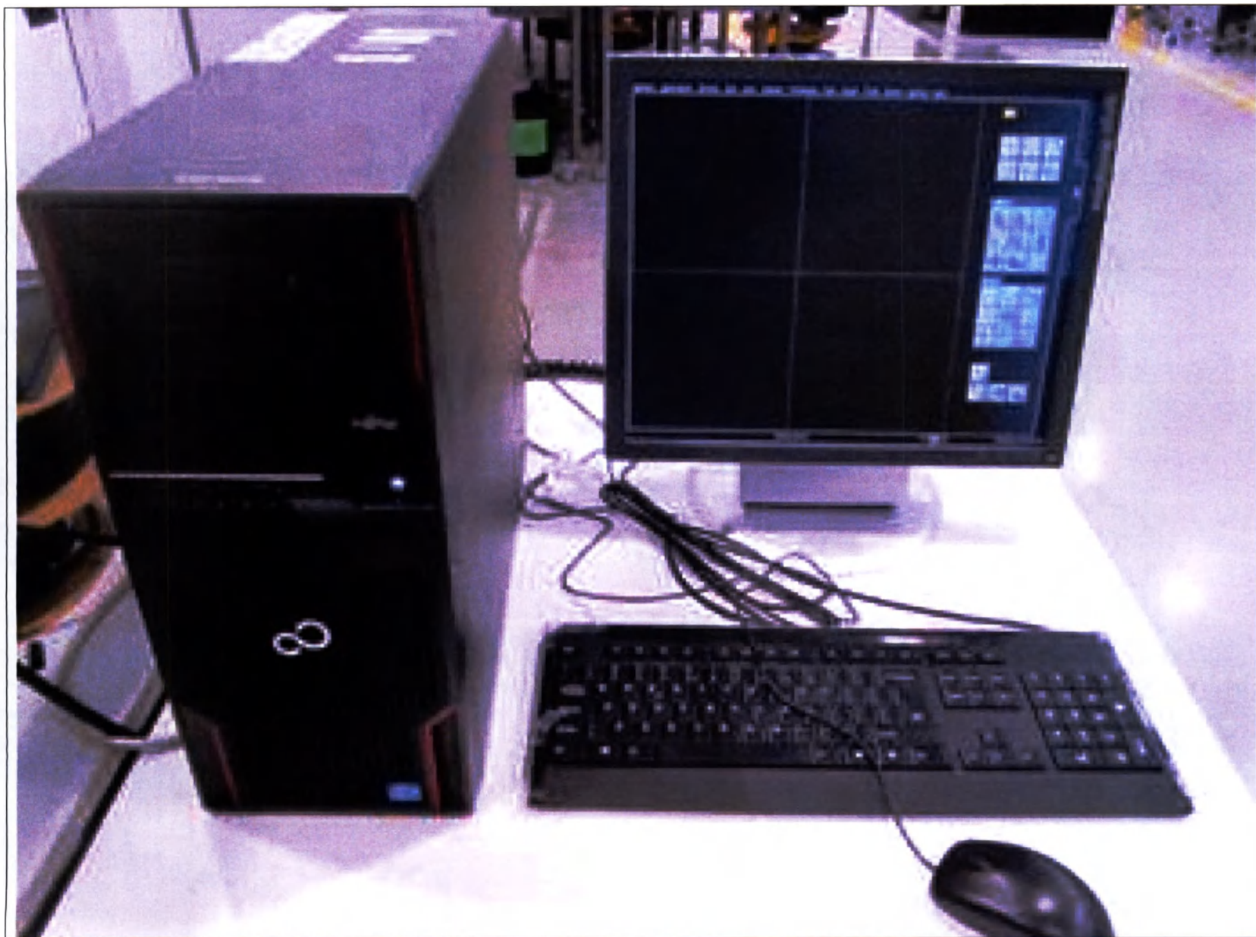
61. Дополнительная рабочая станция оператора в составе: мониторы, системный блок, мышь, клавиатура.
