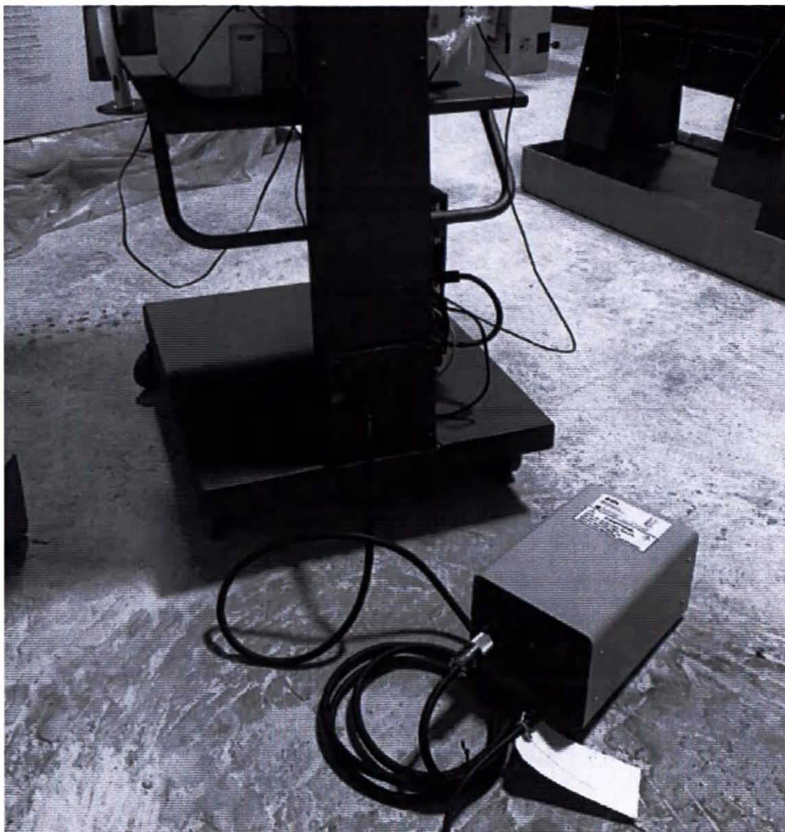
Место подключения Стойки для компьютера к Трансформатору изоляционному
