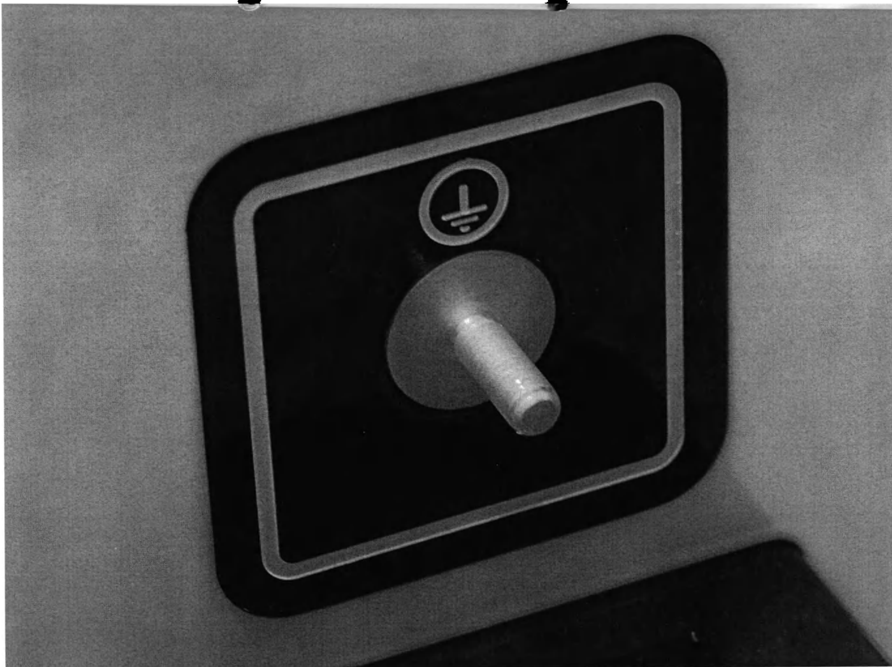
Фотография 33. Контакт заземления.
