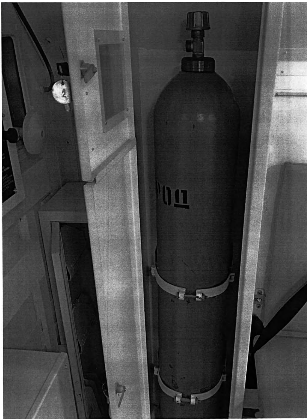
Фотография 2.2. Баллон 40-150У для кислорода (в шкафу для баллона).
