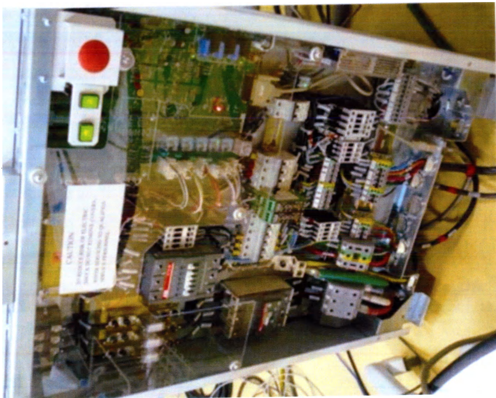
39. Распределительный щит питания.
