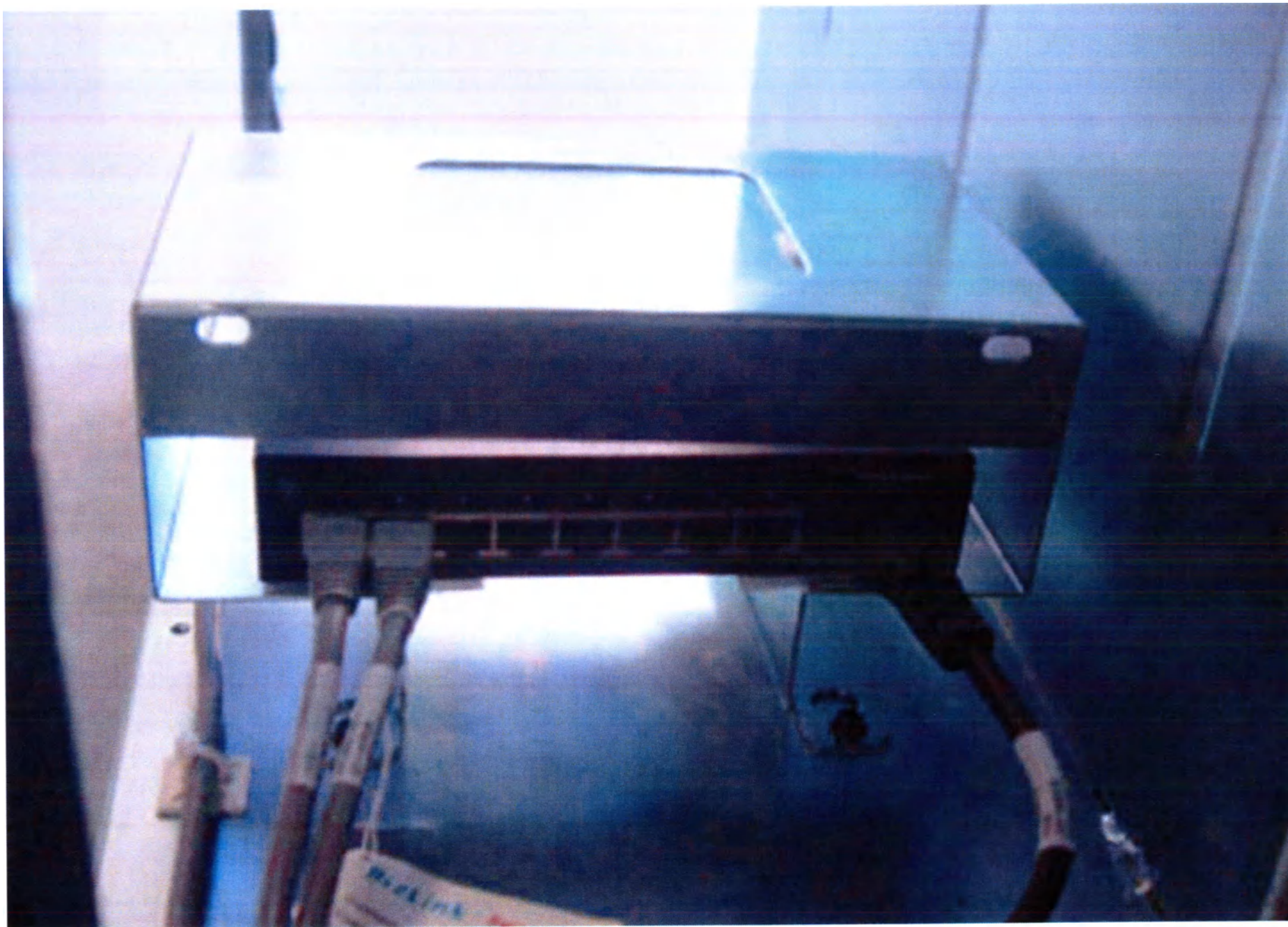
49. Сетевое оборудование: переключатели (не более 20 шт.), коммутаторы (не более 20 шт.), передатчики (не более 20 шт.).
