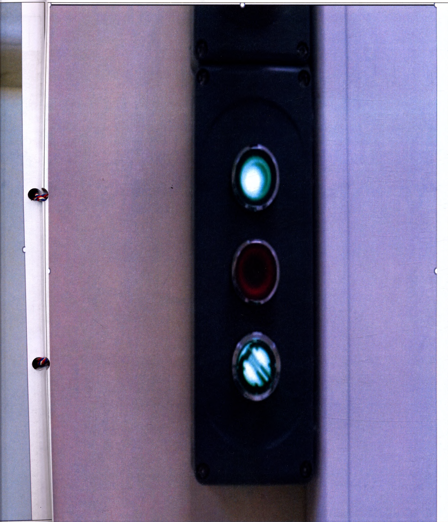
54. Рубильник включения электропитания.
