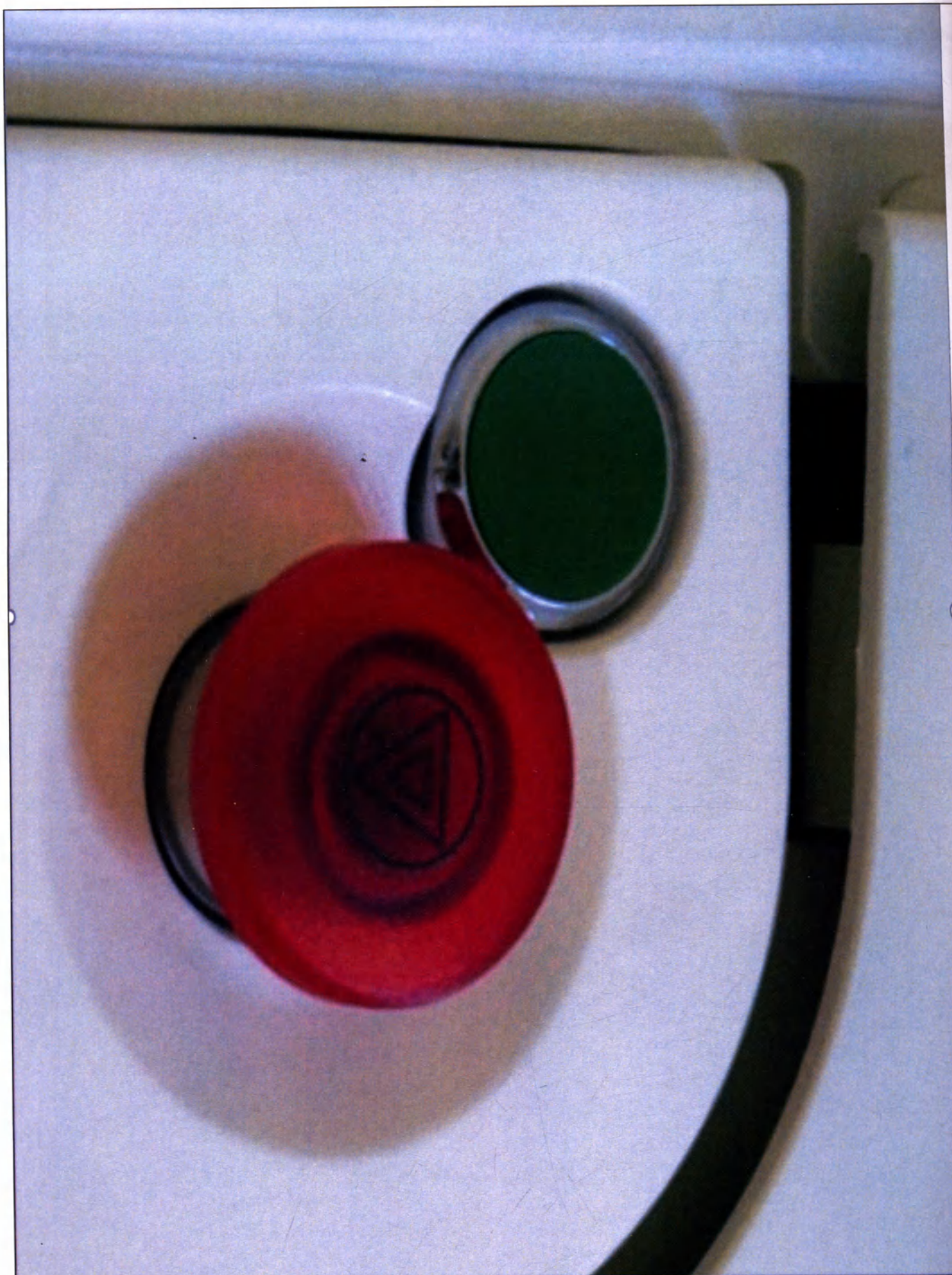
53. Рубильник аварийного выключения.
