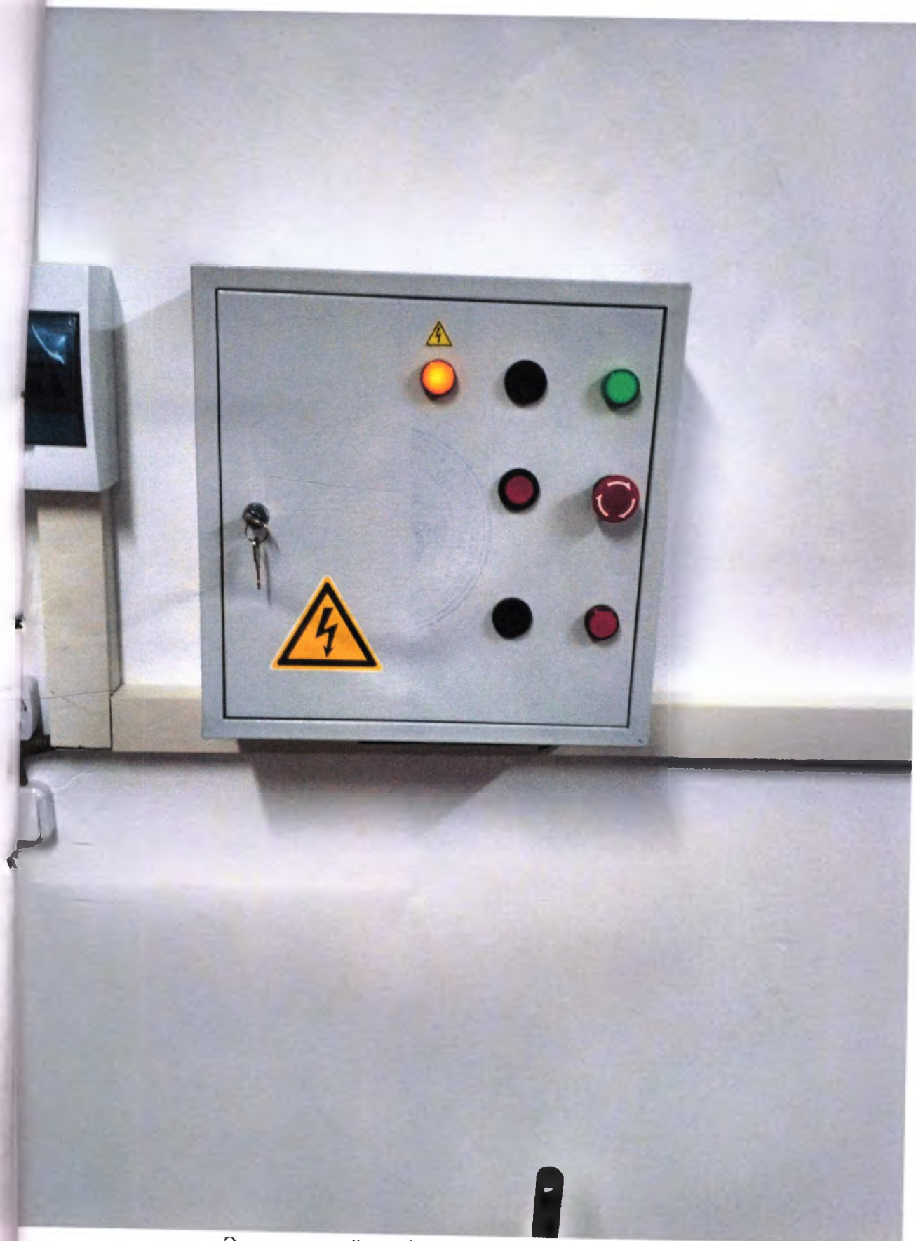
Электрический шкаф управления измельчителем
