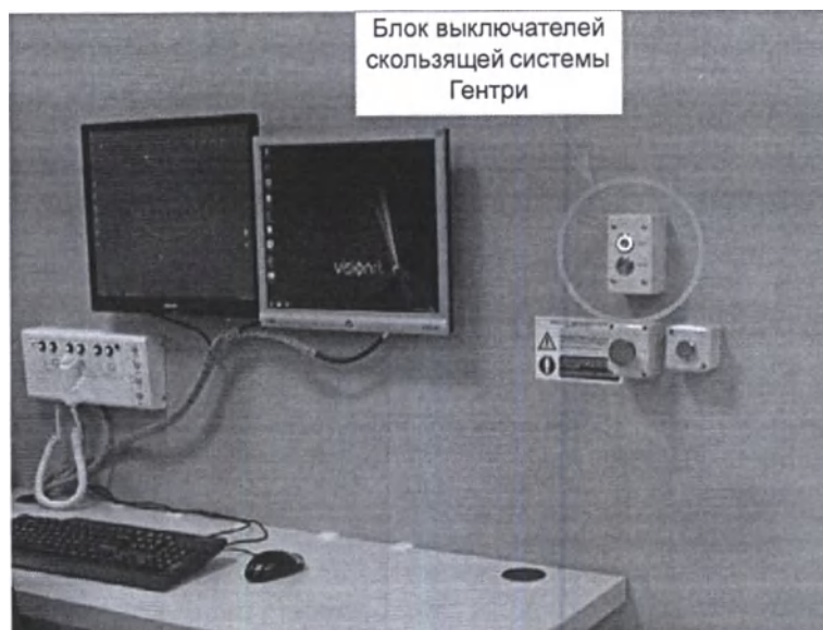
Рисунок 5-6. Расположение блока выключателей скользящей системы Гентри — Камера для рентгенографии в помещении TR
