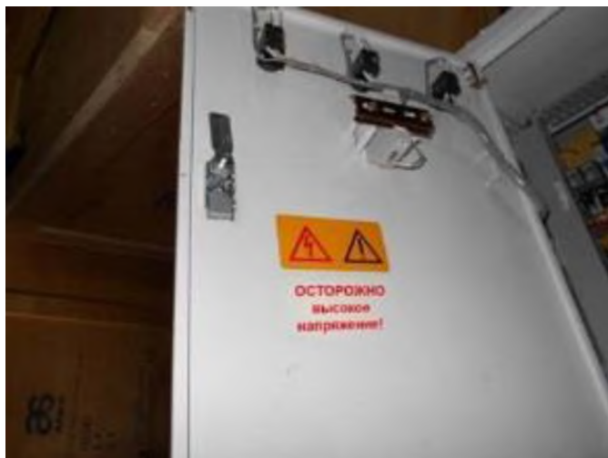
Рисунок А-37 Значки предосторожности на электрораспределительном щите
