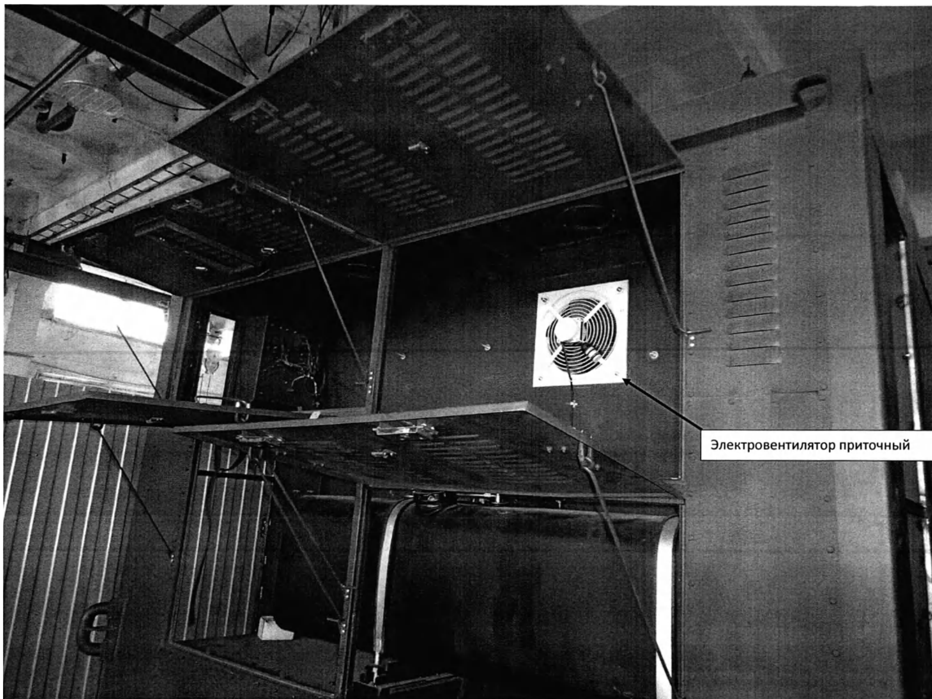
Фотография 9. Электровентилятор приточный (расположен на передней панели кузова-контейнера установки).
