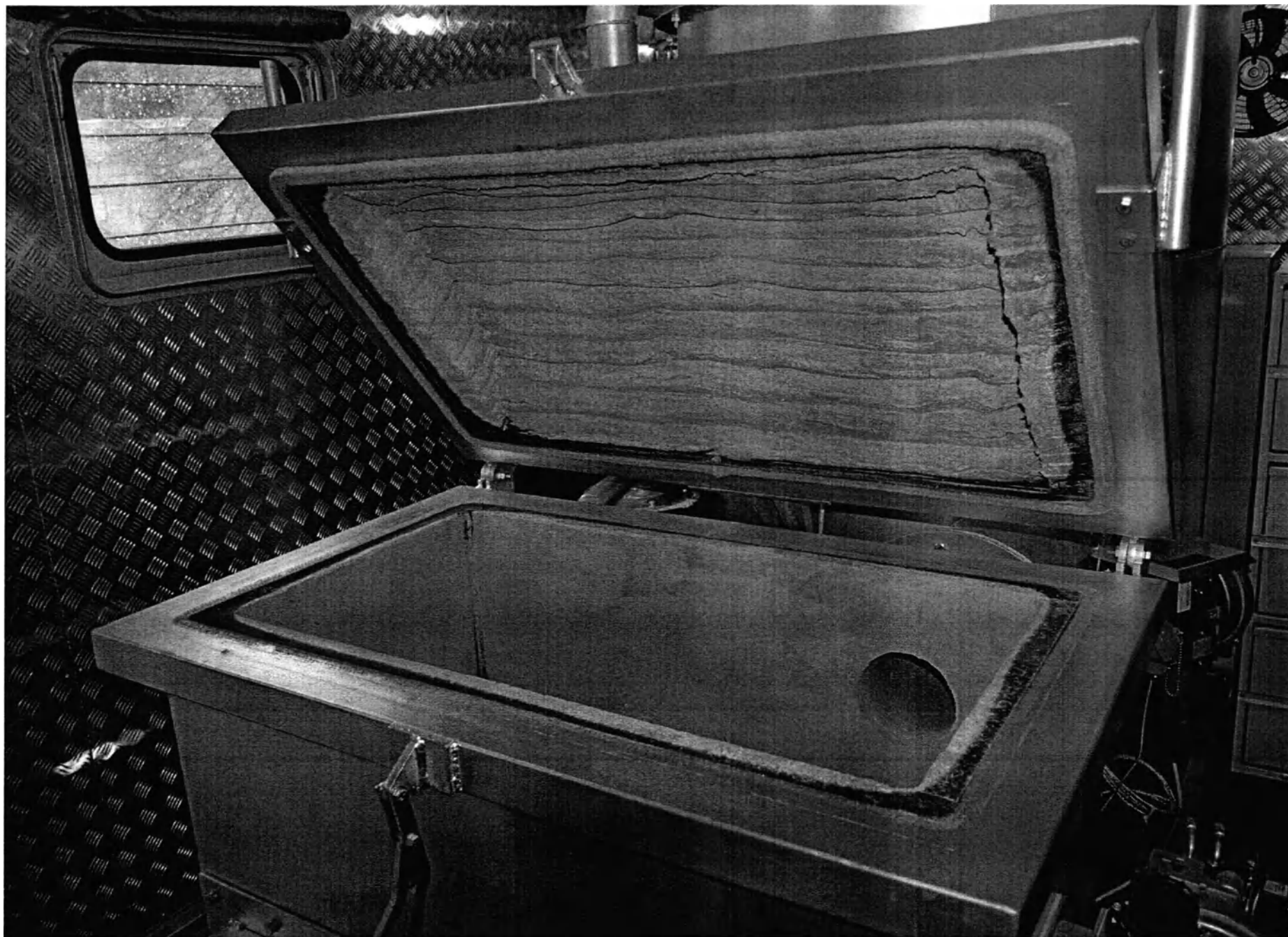
Фотография 5. Камера сжигания инсинератора ИНСИ-В-300 в открытом виде.
