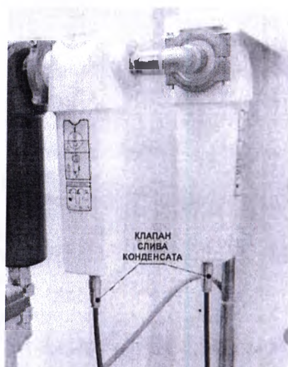
Рисунок 12.1 – Фильтры, установленные в адсорбционном осушителе SEC 7HC (слева направо: циклонный, микронный, субмикронный)
