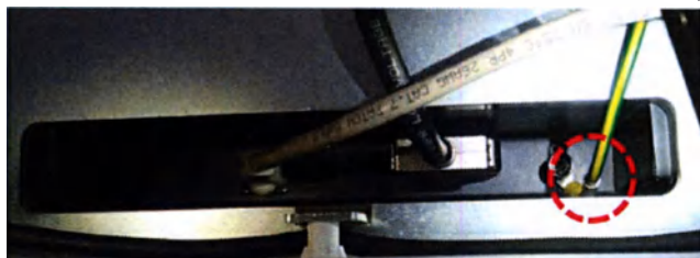
Рисунок 3-125. Подключение кабеля заземления к детекторам GU60A / GU60A-65.
