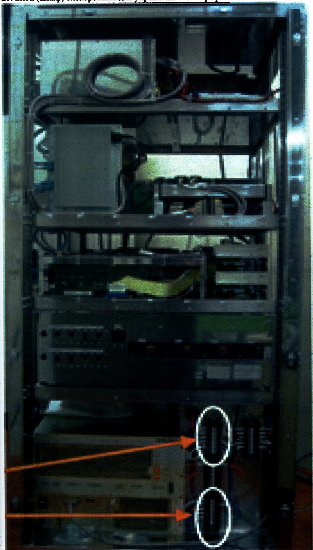
21. Блок (шкаф) электроники для управления томографом.
