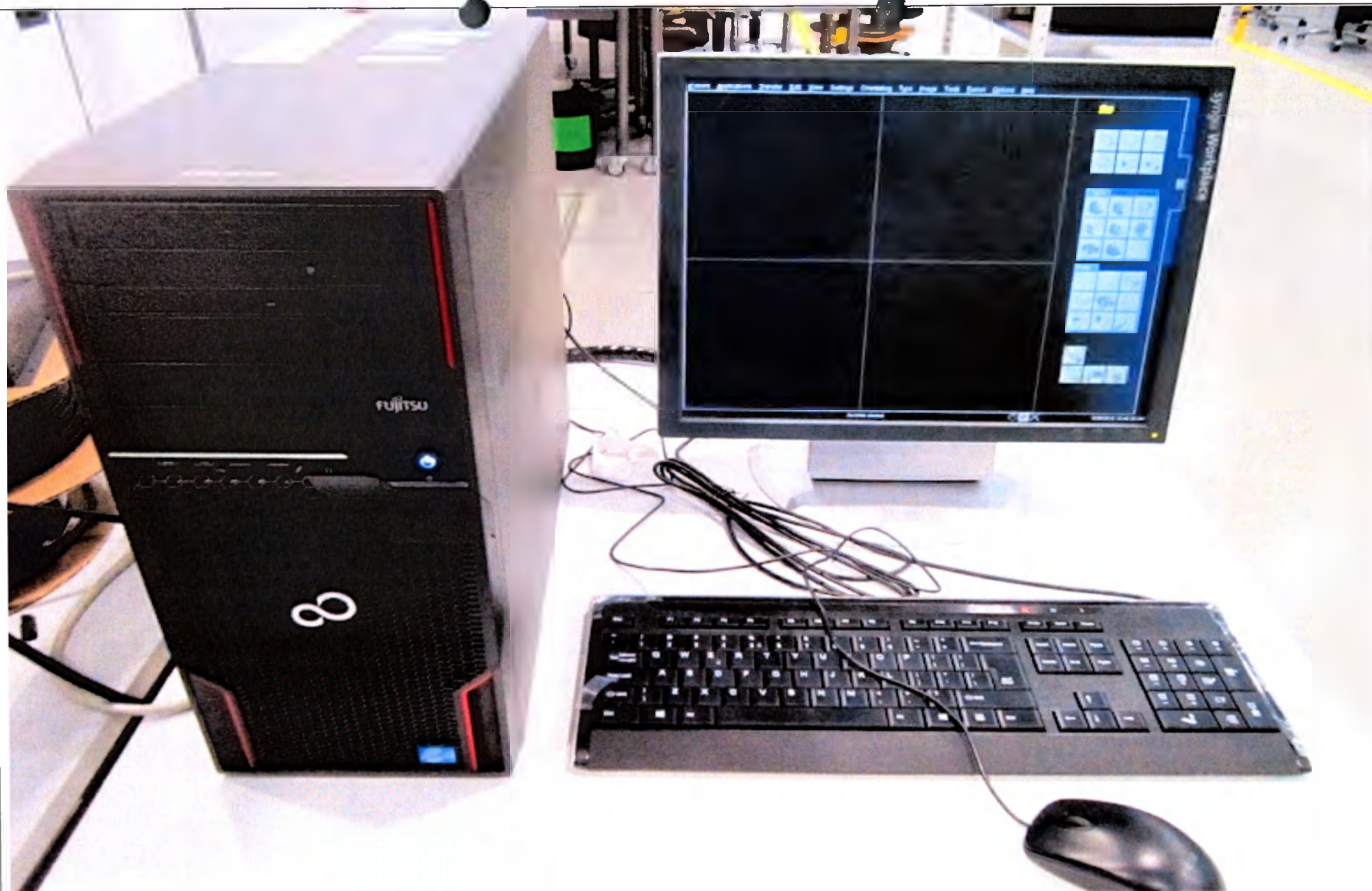
ДОПОЛНИТЕЛЬНАЯ КОНСОЛЬ УПРАВЛЕНИЯ, В СОСТАВЕ: МОНИТОРЫ, СИСТЕМНЫЙ БЛОК, МЫШЬ, КЛАВИАТУРА
