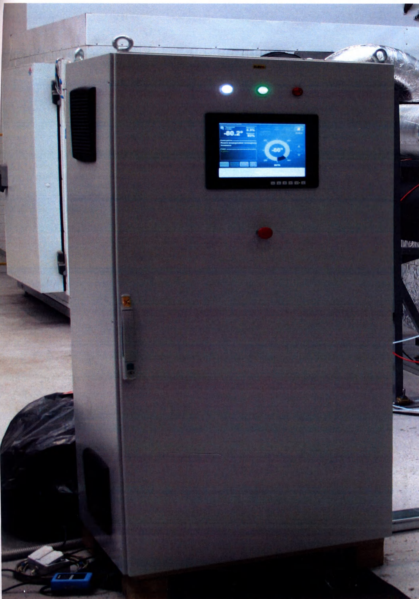
Рис. 3 - Шкаф силового тока и управления, в составе:
