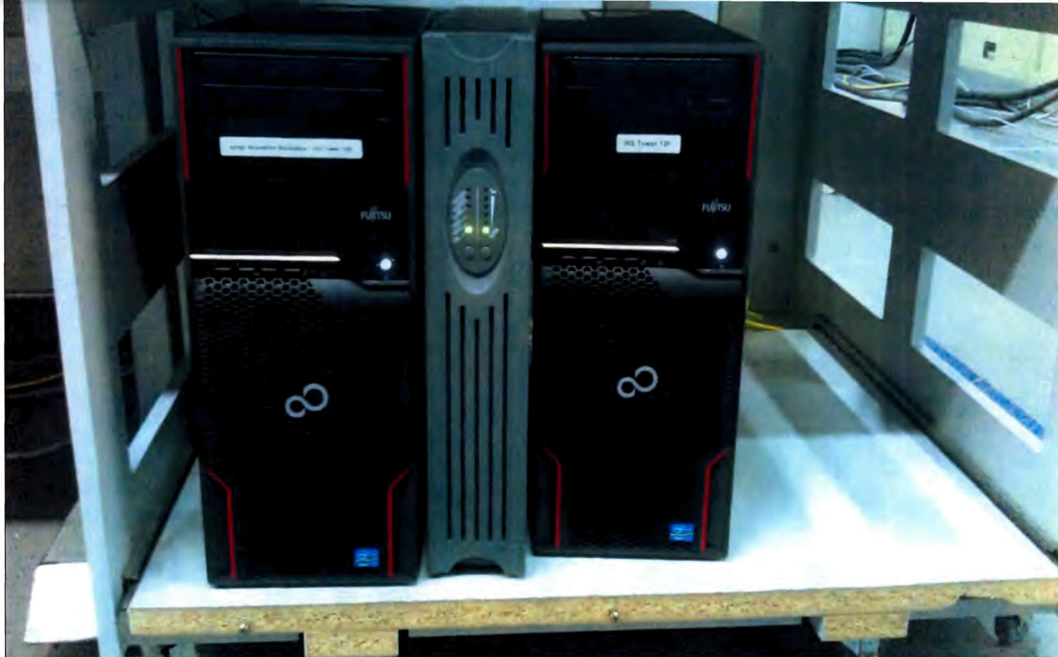
Рисунок 39а. Сателлитные консоли управления, в составе:- монитор;- системный блок;- клавиатура;- мышь;- кабели соединительные
