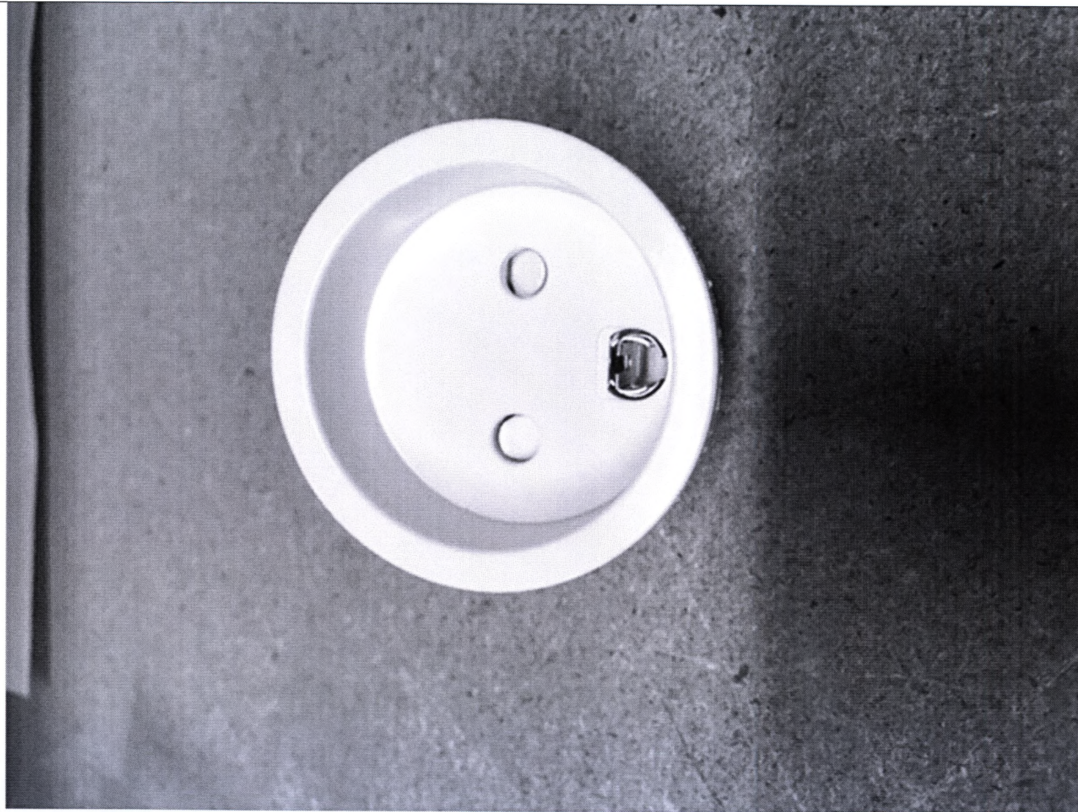
Розетка 220 В на корпусе установки М-285
