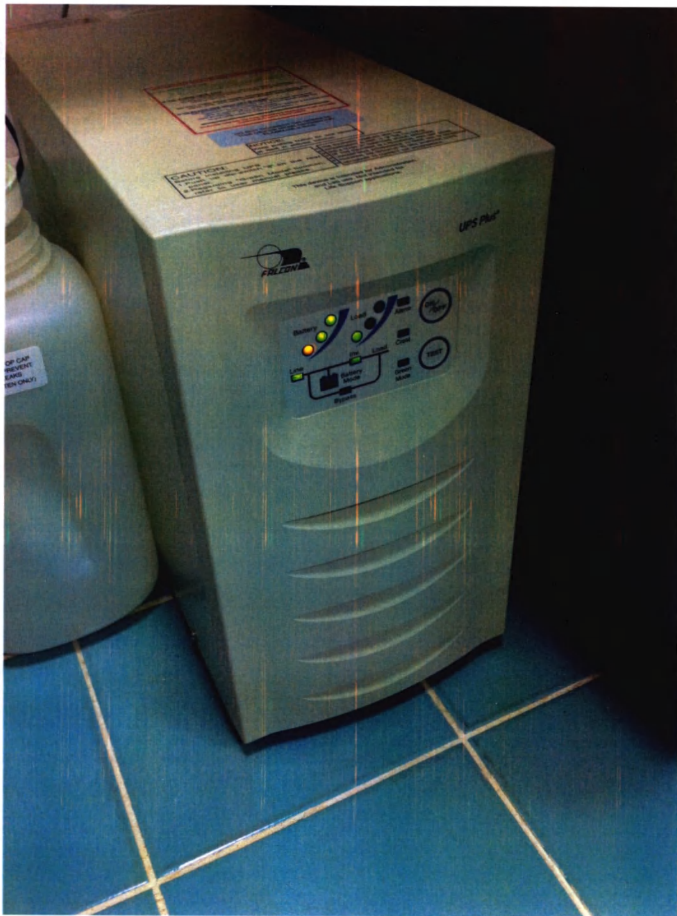
12. Источник бесперебойного питания. Общий вид.
