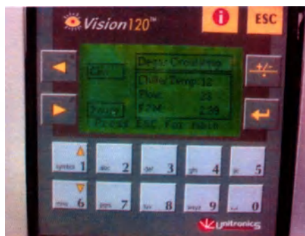
Рисунок 3-2. Панель управления системы циркуляции воды
