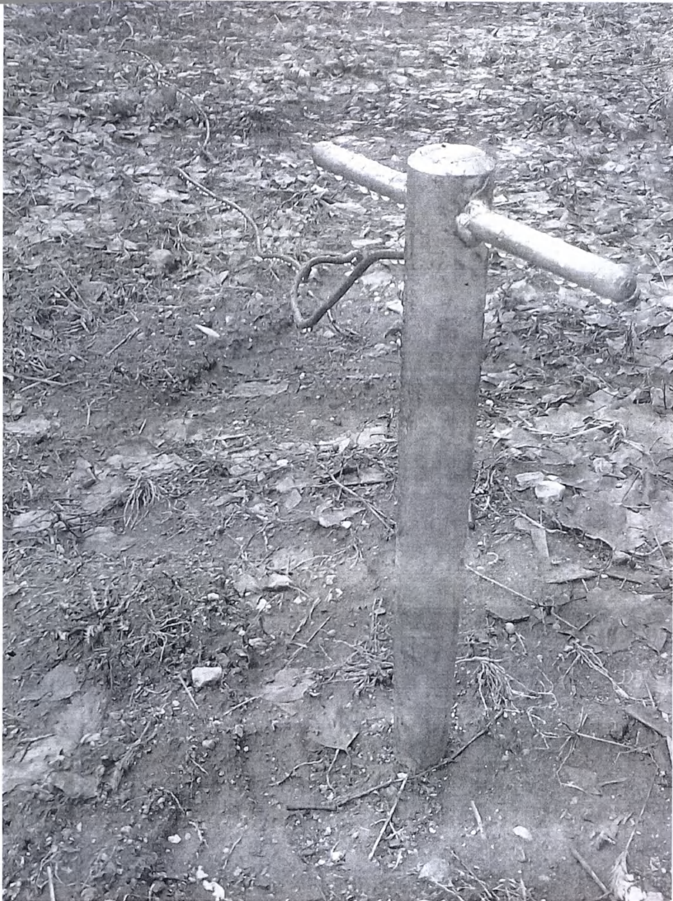
Фотография 10. Заземляющее устройство. Общий вид.
