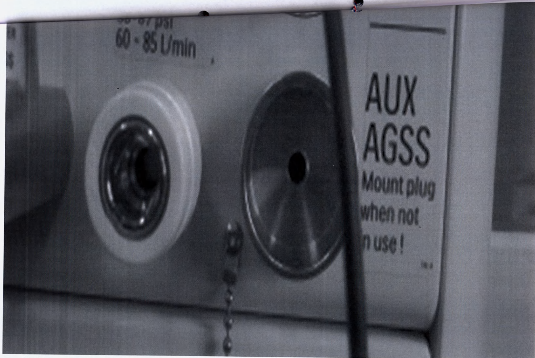
Системы эвакуации газов (не более 10 шт.)
