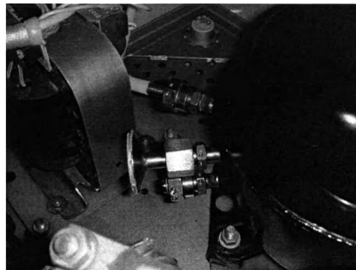
Рисунок 14. Фильтр грубой очистки установлен на компрессор
